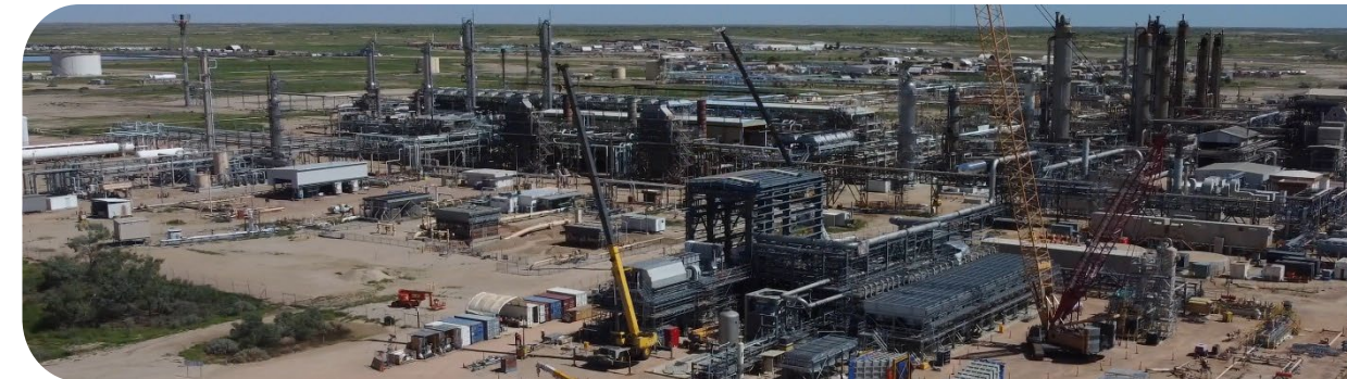
Moomba CCS Facility, Moomba SA
