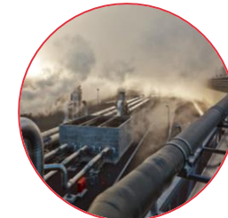
Te Mihi Stage 2 Geothermal
