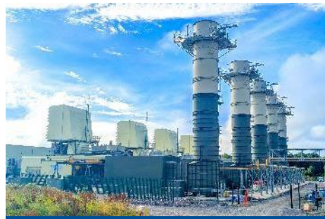
Bypass & HRSG Exhaust System
